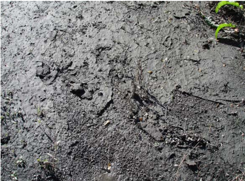
SABA Sihlbrugg Kt. Zug, Ablagerungen auf Splittschicht
