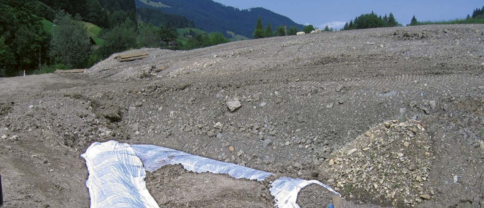
Foto 17: Drainagemassnahmen im Deponiekörper (Foto AfU)
