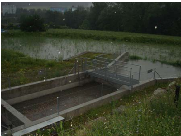
Starkregen vom 17.6.2010 Filterbecken eingestaut
