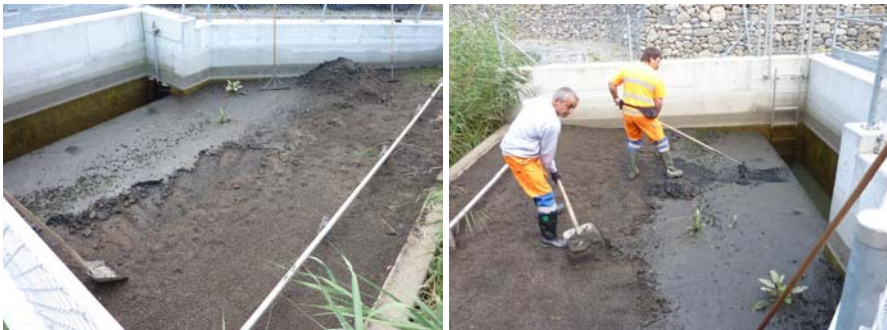
Unterhalt am Kiesfilter, Handarbeit, aber problemlos
