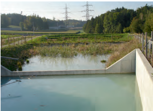
Abb. 8 A4.1.6 Auslegung der SABAs auf den Baustellenbetrieb: Beim Beispiel SABA Chüeweid, wird während dem Bau der Strasse das Baustellenabwasser vor der Einleitung ins Gewässer im Absetzbecken und im Kies- und Sandfilter behandelt.
