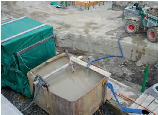
Abb. 6 A4.1.6 Baustellenseitige Absetzbecken sind meist viel zu klein, um die bei Regen anfallende Trübung zurückzuhalten.
